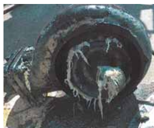
△タオルが絡まって停止した汚水ポンプ
