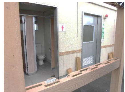
(壊された目隠し用の板)
